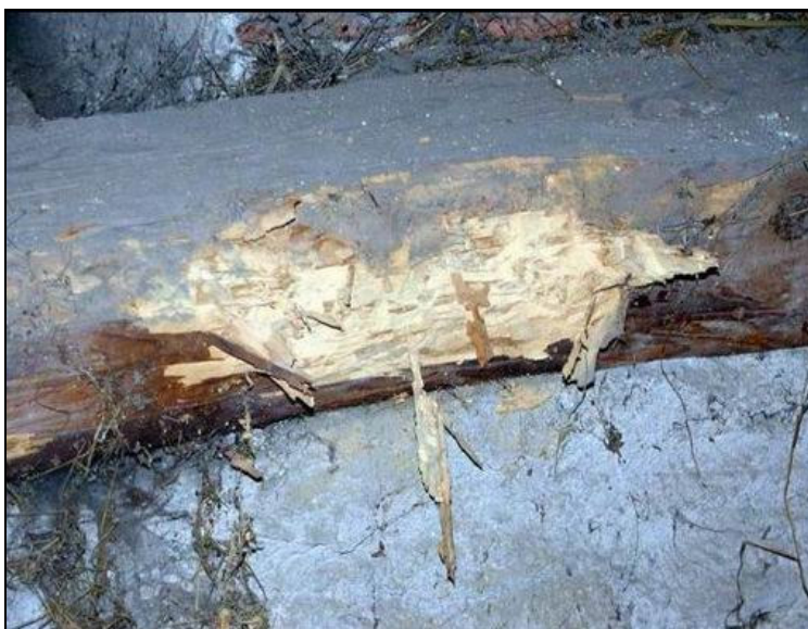
Obrázek 3: Část krovu poškozená činností larev tesaříka krovového. Foto Michal Kloiber
